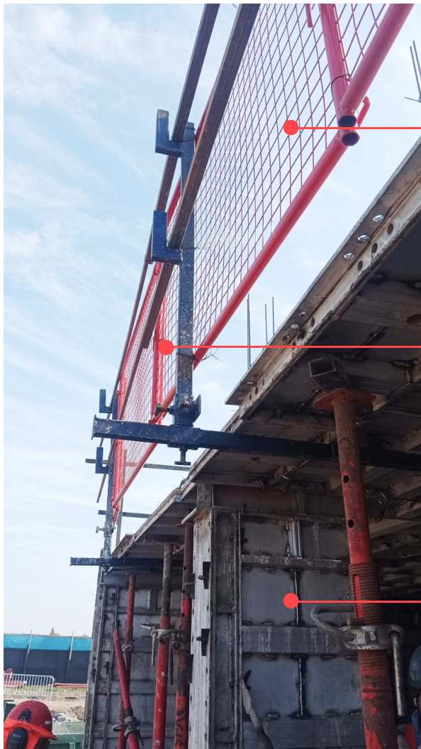
Accesorio en obra
